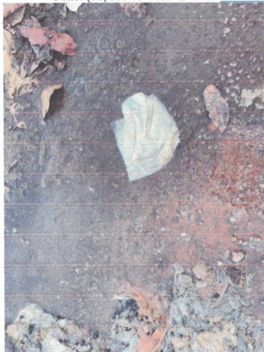
Foto 01: Limpeza caixa de esgoto, vide papel higiênico e muitos resíduos.
