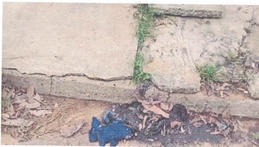
Foto 05: Limpeza caixa coletora, retirados muitos resíduos sólidos, cabelos, roupa íntima.
