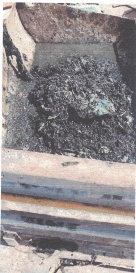
Foto 06: Limpeza PV (ponto de visita rede), ver muitos resíduos sólidos, até garrafa pete.
