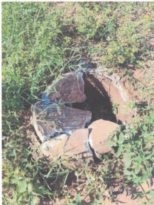
Foto 07: Caixa coletora danificada por terceiros que passa dias sem ser arrumada, até que chega a denuncia na SETAE.
