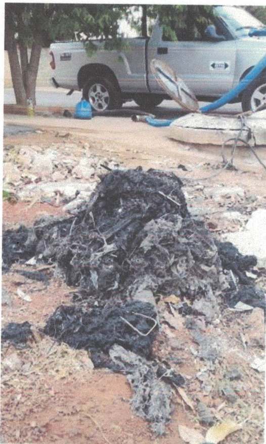
Foto 04: Limpeza PV (ponto de visita rede), ver muitos resíduos de papel, cabelos, plásticos.
