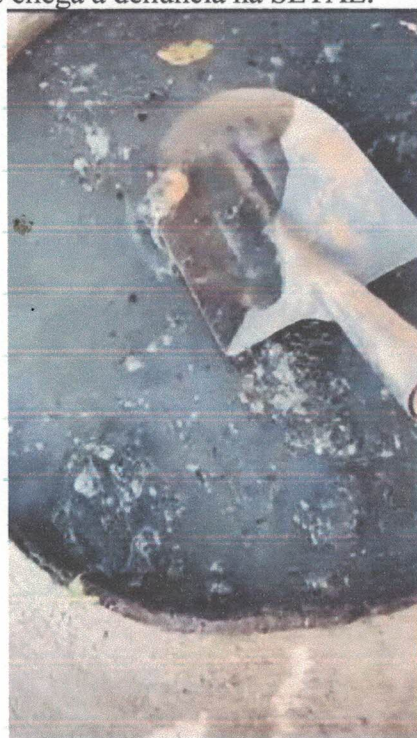
Foto 08: Limpeza PV (ponto de visita rede), ver muitos resíduos sólidos, e dentro da pá o OB dispositivo absorventes de mulheres que é jogado no vaso sanitário que ao ficar em imerso na água aumenta de tamanho e causa muito entupimento na rede de esgoto.
